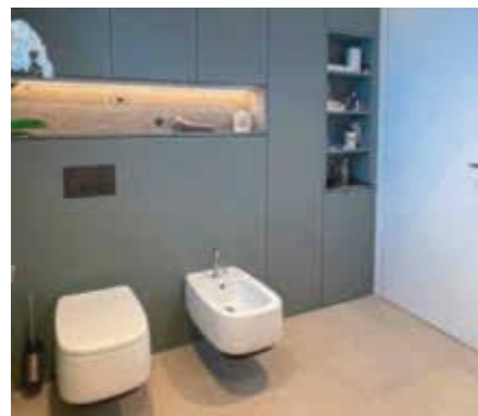
Überraschende Lösung: Hinter der Wand befinden sich die Wasseranschlüsse
